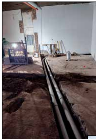
Underground electrical conduit
